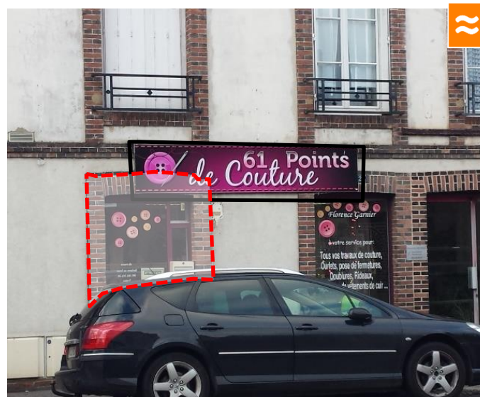
Enseigne masquant les éléments architecturaux de la façade (encadrements en brique) et dénaturant le bâtiment – L'Aigle Source : EVEN Conseil
